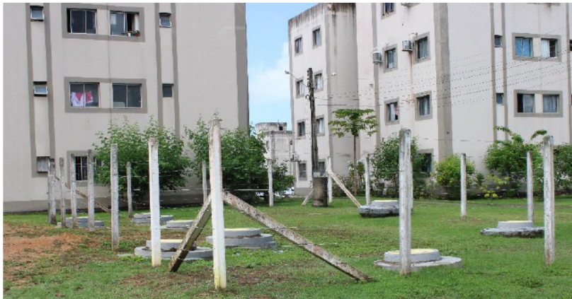
Figura 6 - Sistema fossa – filtro de Maceió
