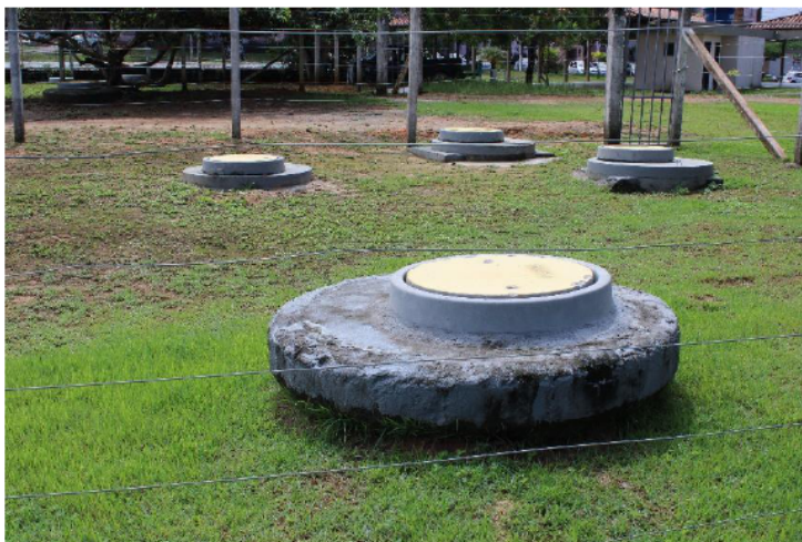
Figura 7 - Sistema fossa – filtro de Maceió
